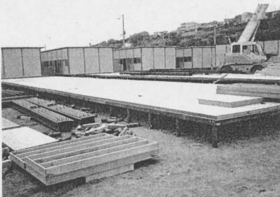
5. 床版敷込—コンパネに棧木を取り付けた床パネルが使用されている。
