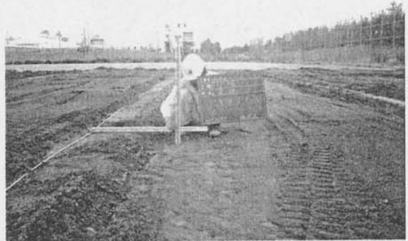
2. 粗造成—床下排水を考慮し、通路部の土をスキ取り床下部に盛土を行う。
